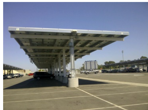
PV Solar Canopy
